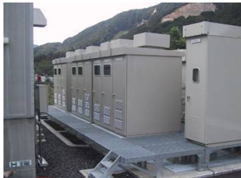
回生電力貯蔵システム(JR西日本)
