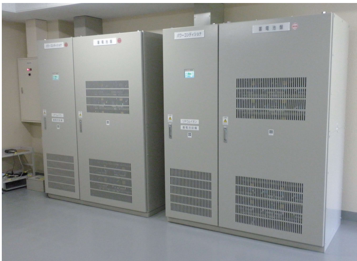
火災予防条例に適合したキュービクルに蓄電池を収納
