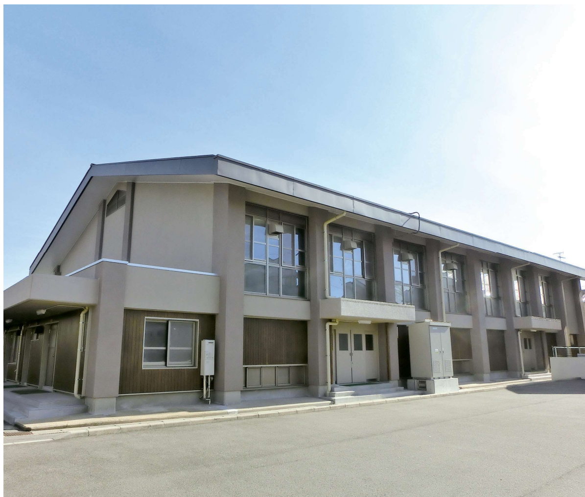
体育館横に屋外キュービクルで設置された蓄電システム
